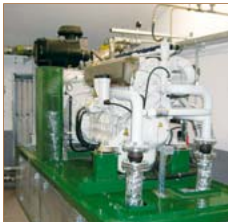
Photo 6 : Moteur biogaz (source Aile)
